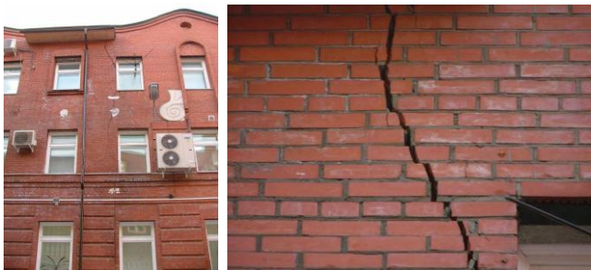
Рис. 8. Развитие вертикальных и наклонных трещин вследствие неравномерной осадки фундаментов
