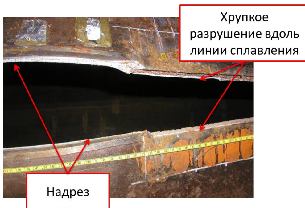
Рисунок 1.4 – Внешний вид разрушения труб с надрезом по центру шва [54]
