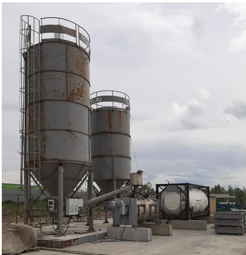
Рисунок 6.3 – Установка литификации фильтрата на полигоне ООО «Новый Свет-ЭКО»
