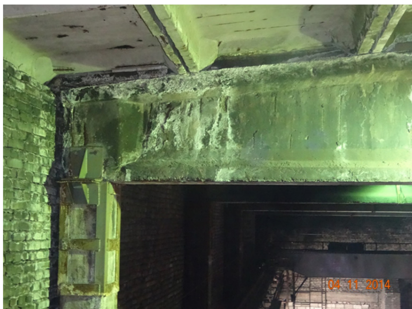
Рисунок 4.11 – Участок двускатной стропильной балки Б7 с характерными дефектами и повреждениями
