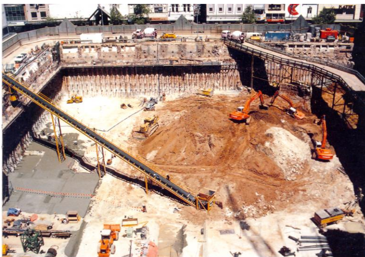
Рис. 4.22. Устройство фундаментов «стена в грунте» из секущих буровых свай в центре г. Мюнхена (Германия)
