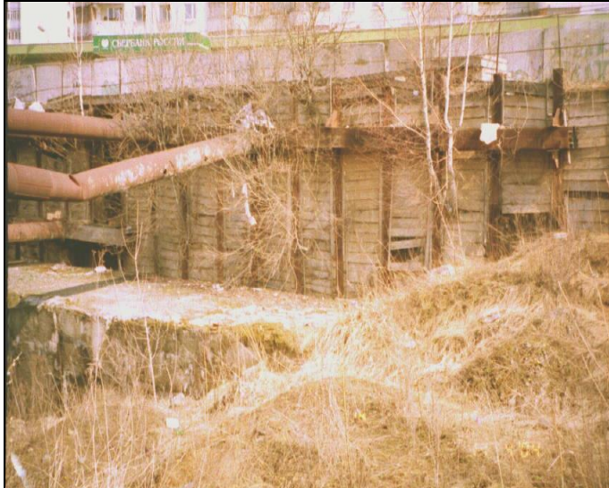
Рис. 3.72. Зброшенний котлован. Деформації распорок
