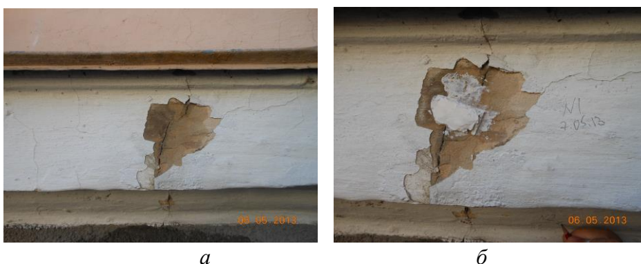
Рис. 7.1. Существующая трещина (а) в несущей стене объекта геомониторинга и гипсовый маяк (б) на ней с указанием даты его установки
