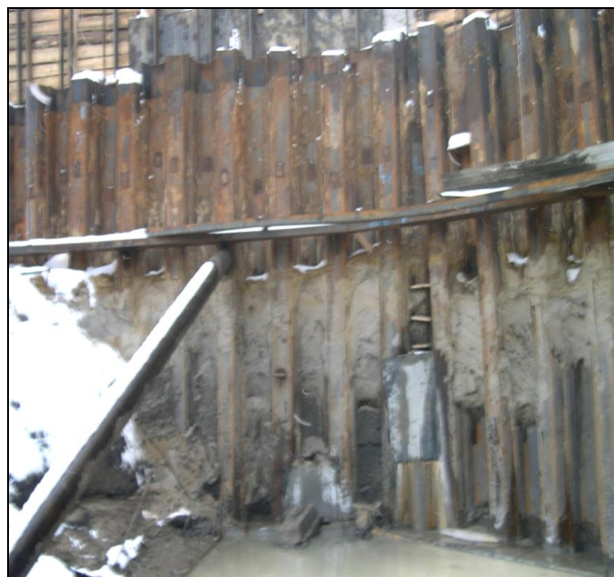
Рис. 3.70. Деформации распределительной балки из-за отсутствия ее сопряжения с подкосом
