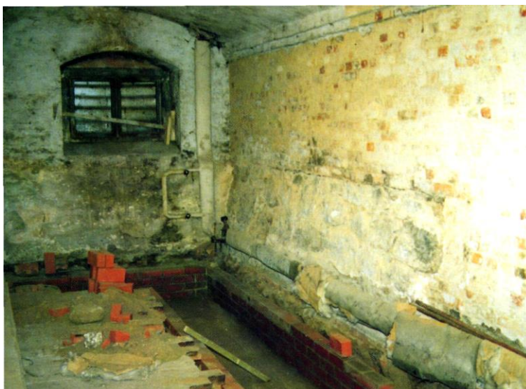
Рис. 5.1. Разрушение стен подвального помещения в результате замачивания подземными водами
