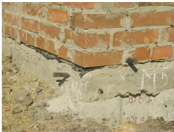
Рис. 7.2. Поверхностные (стенные) марки на цоколя в несущих стенах объекта геомониторинга для фиксации их осадок
