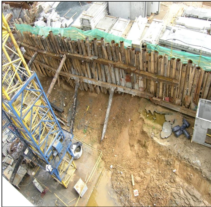
Рис. 3.71. Неудовлетворительное качество конструкций ограждения
