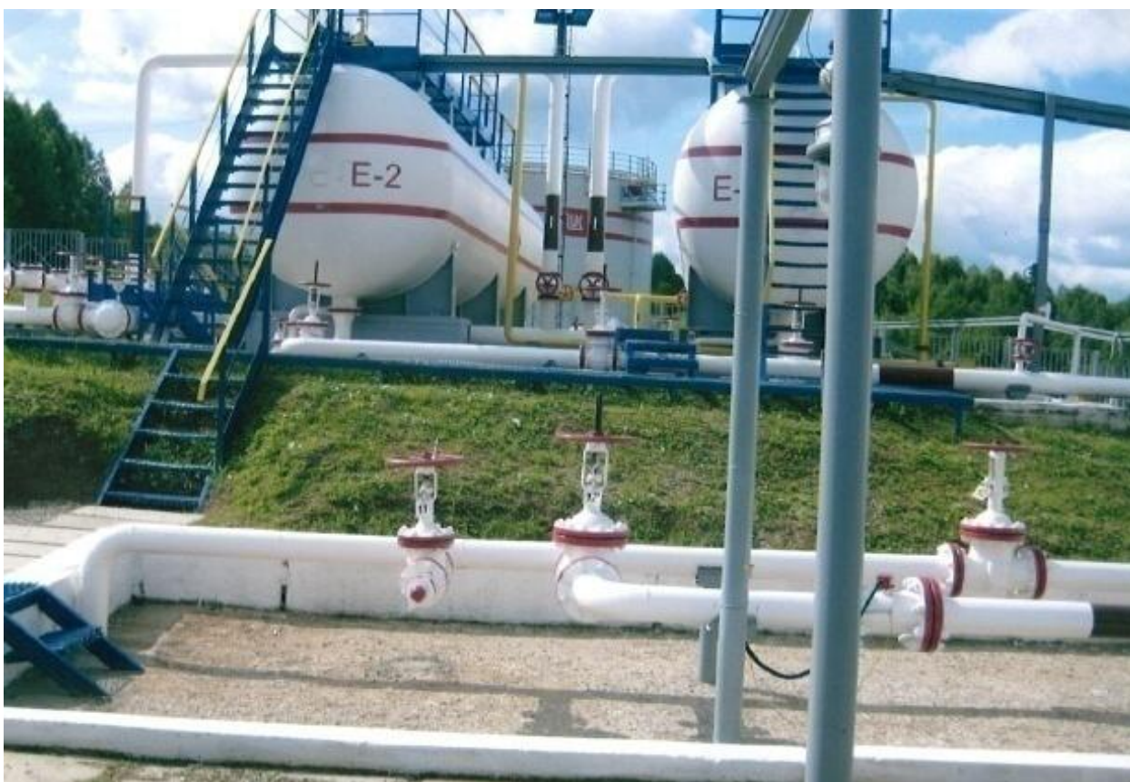
Рис.11.2. Дожимная насосная станция
