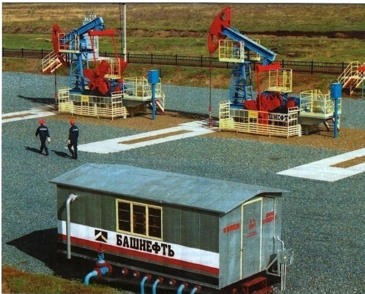
Рис.11.2. Автоматизированная групповая замерная установка
