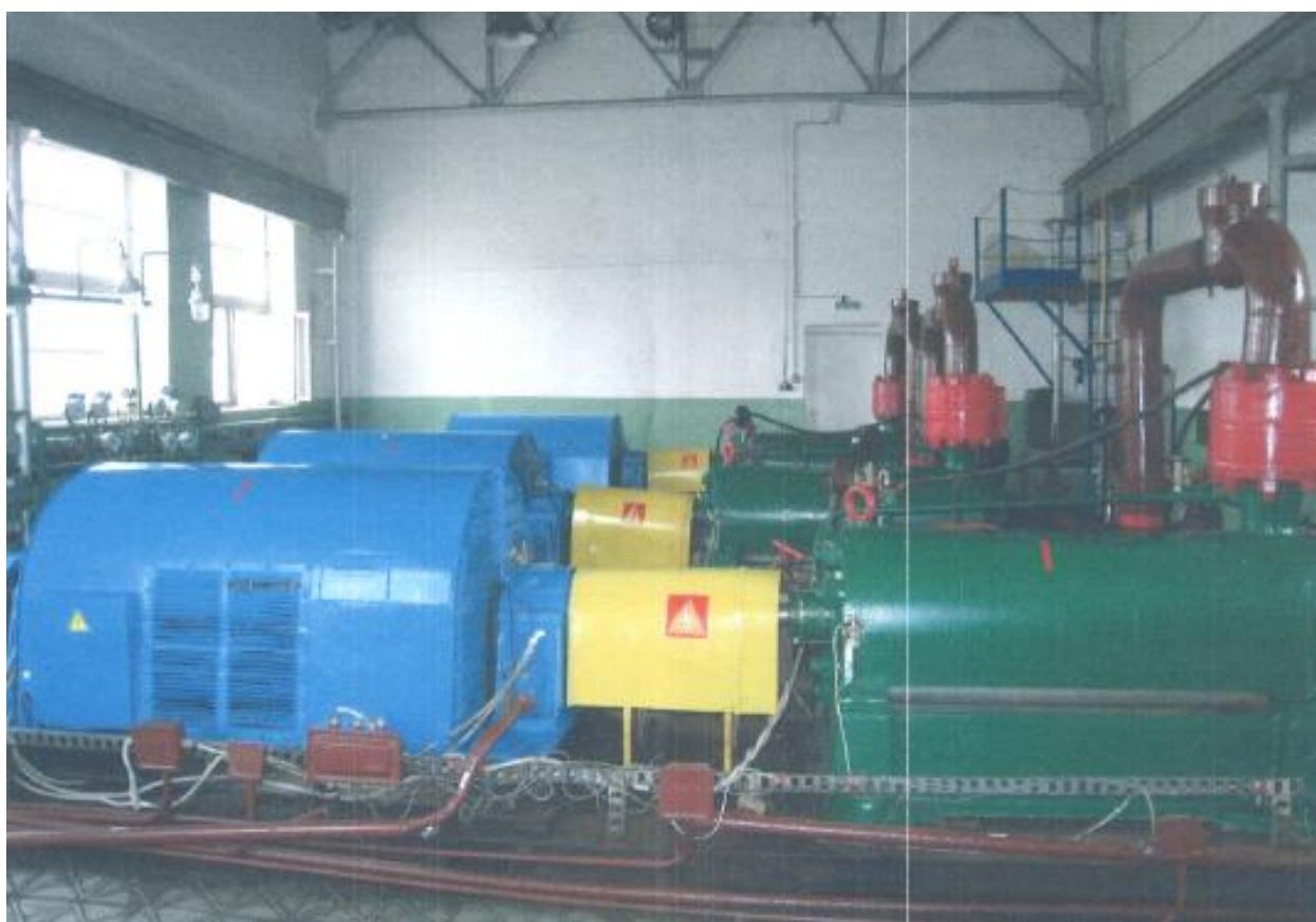
Рис.10.10. Кустовая насосная станция
