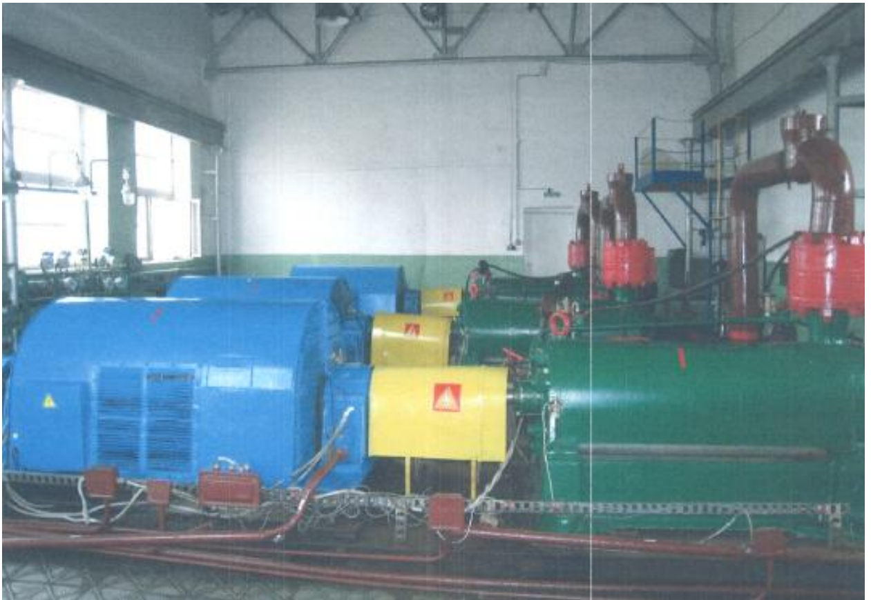
Рис. 1.12. Кустовая насосная станция для закачки воды в нефтяные пласты для поддержания пластового давления
