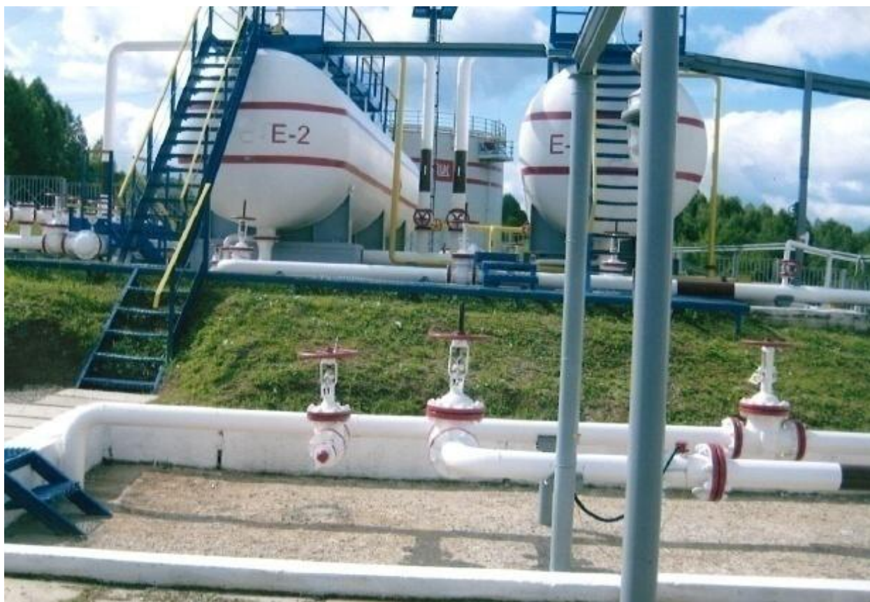
Рис. 1.5. Дожимная насосная станция, объект первой степени сепарации
