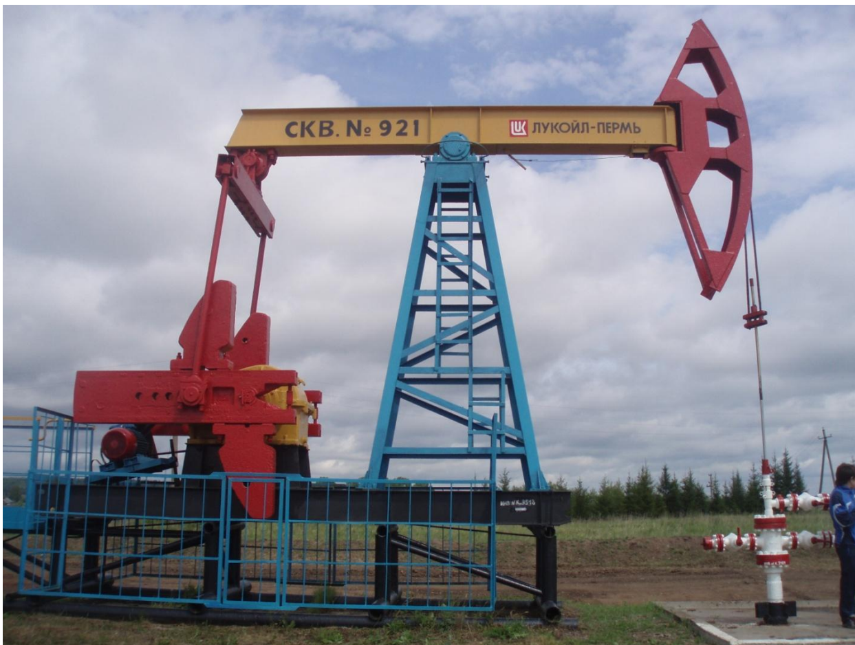
Рис. 1.2. Станок – качалка на фундаменте, сваренном из труб
