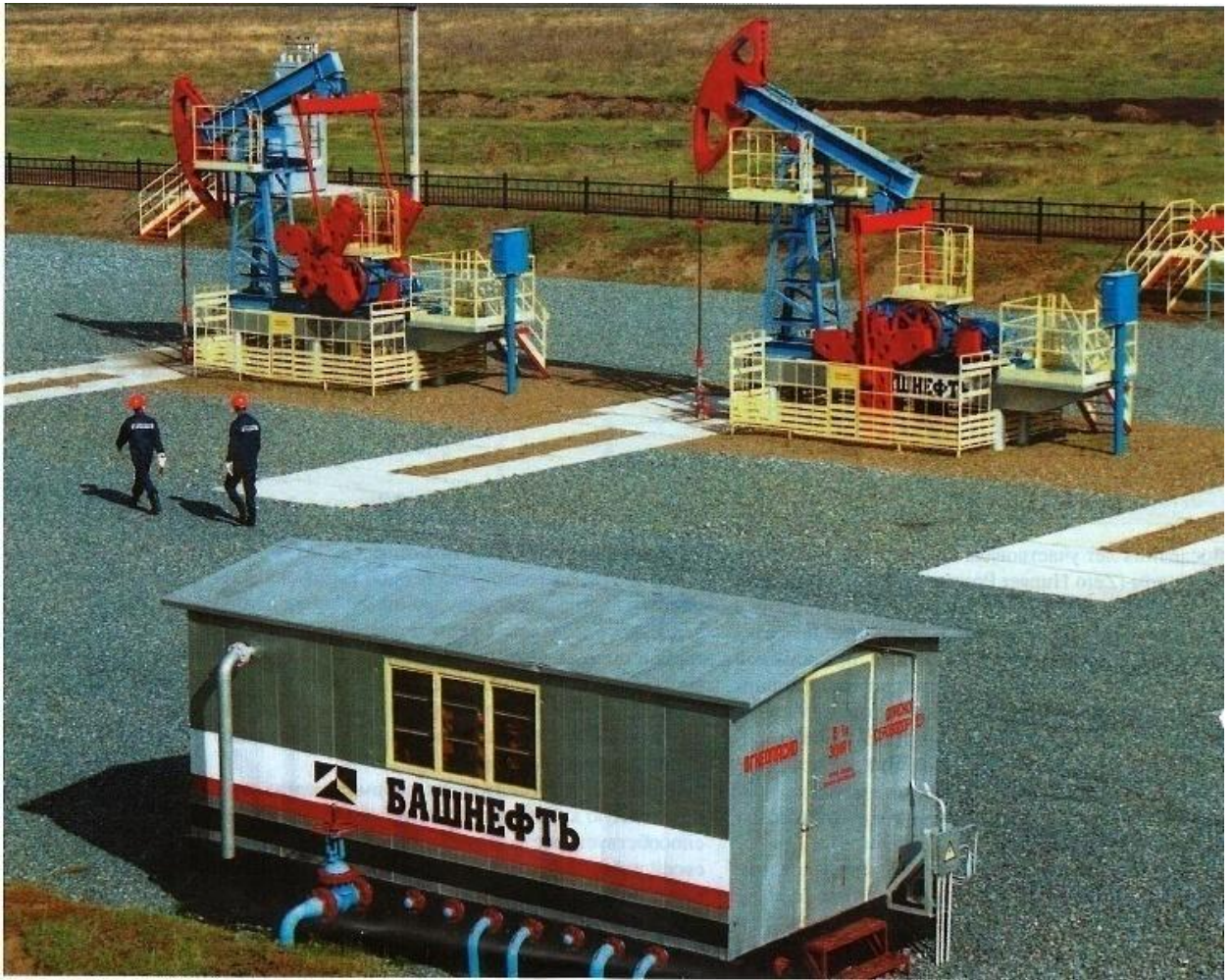
Рис. 1.4. Автоматизированная групповая замерная установка (АГЗУ)
